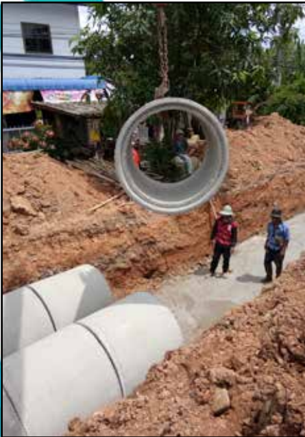
ก่อสร้างผนังกันดินและวางท่อ แก้ไขปัญหาน้ำท่วม หมู่ 2 บ้านแม่กาห้วยเคียน
